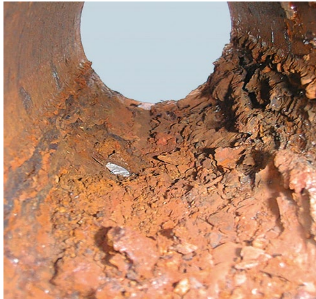
Korrosion im Inneren eines unbehandelten Rohrs
